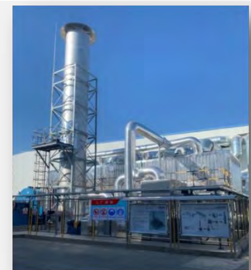
VOC治理工程实例 VOC treatment project
